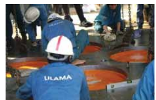
Thi công nền móng máy cho nhà máy xi măng Sông Thao
